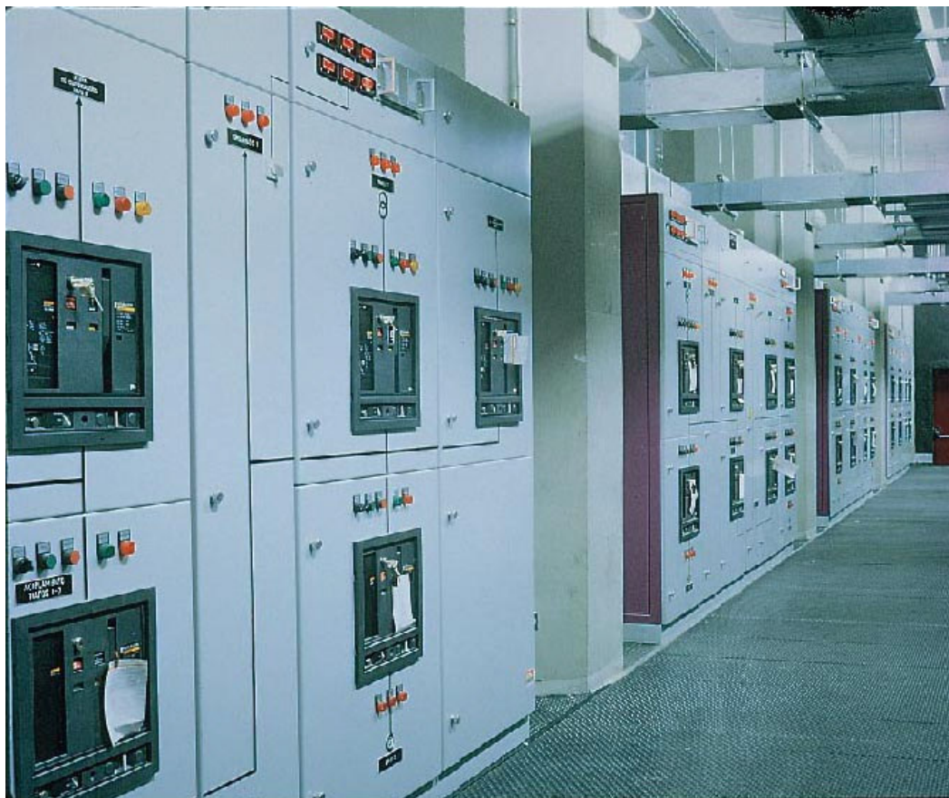
Cuadro de distribución AREBUS de 4000 A para la central Stel de Telefónica Barcelona
